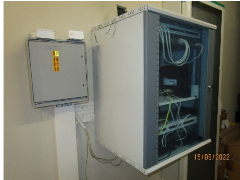
Cassetta di ingresso TELECOM e box dati BD1
