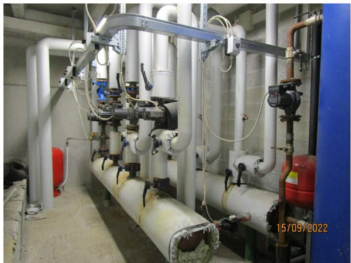
Area di installazione nuove pompe di circolazione
