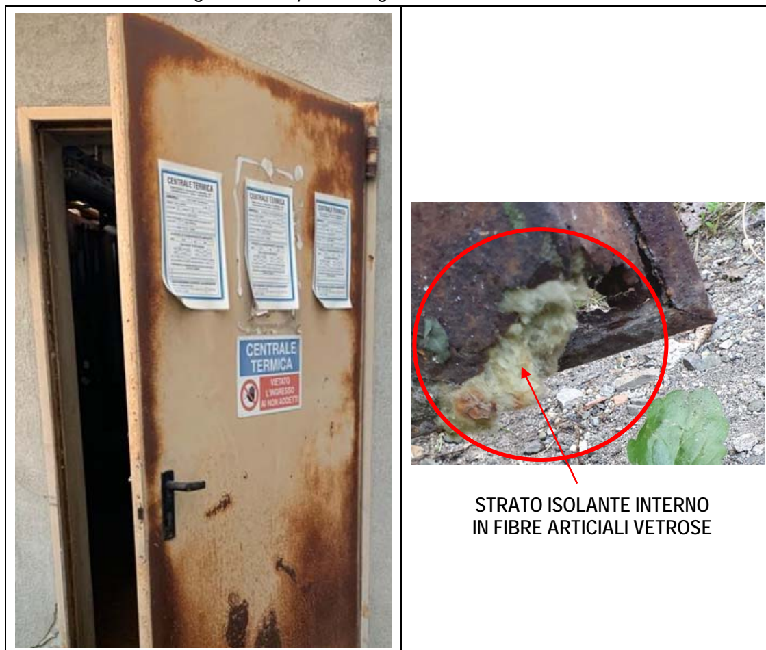
Figura 9: Foto porta di ingresso alla centrale termica
