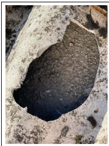
Figura 15: Foto soletta sottostante le lastre di copertura
