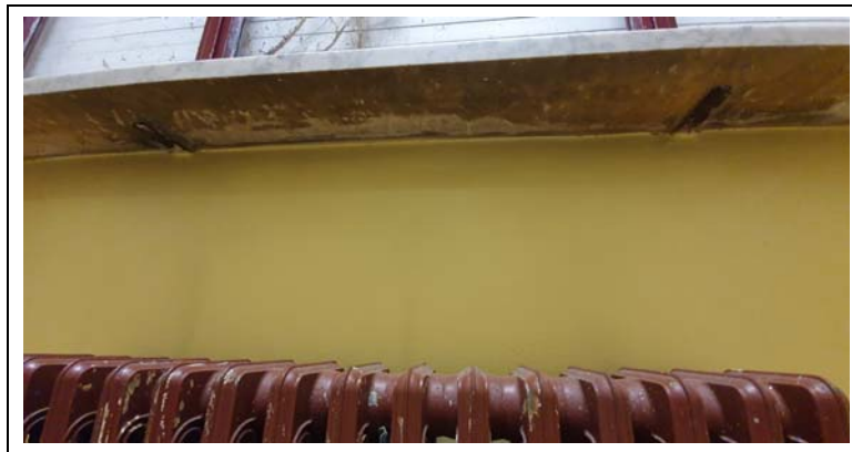
Figura 11: Mensole al di sopra dei termosifoni senza protezioni in amianto
