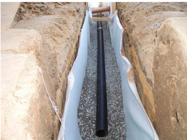
Trincea di drenaggio in ghiaia, avvolta da Tessuto non Tessuto, con tubo microforato interno.
