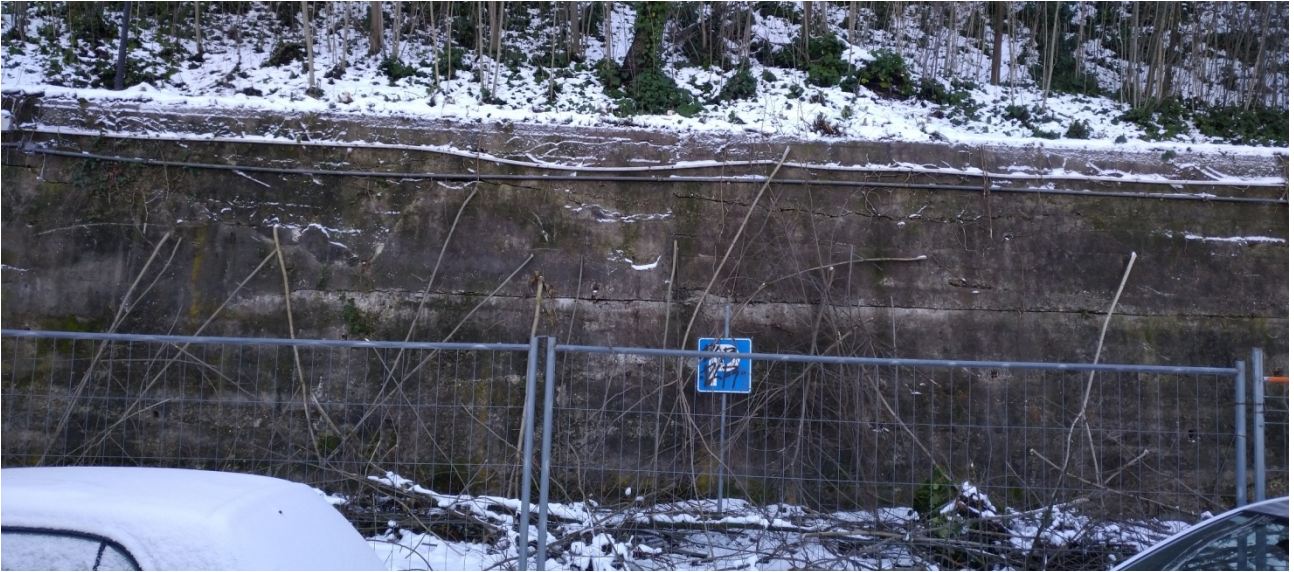
Immagine rappresentativa dei quadri fessurativi
